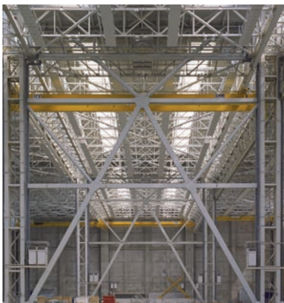
Intalación con paneles radiantes SABIANA a 47 metros de altura
